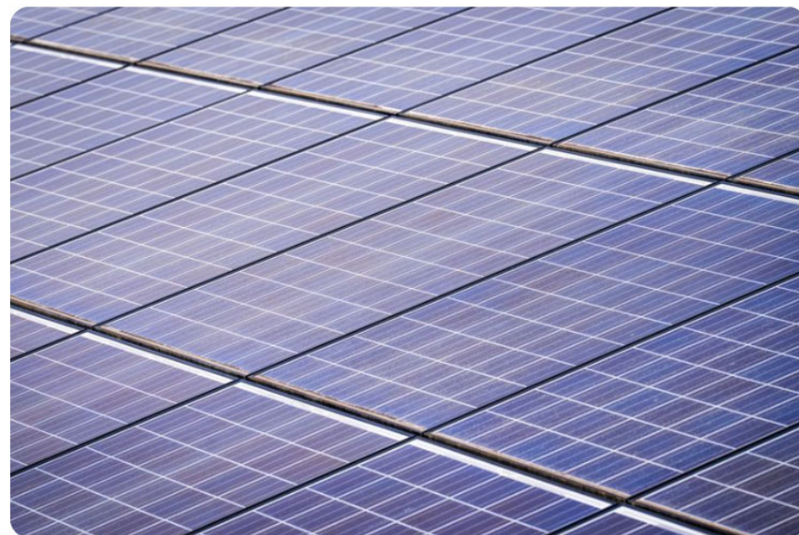
光伏-太阳能电池板
